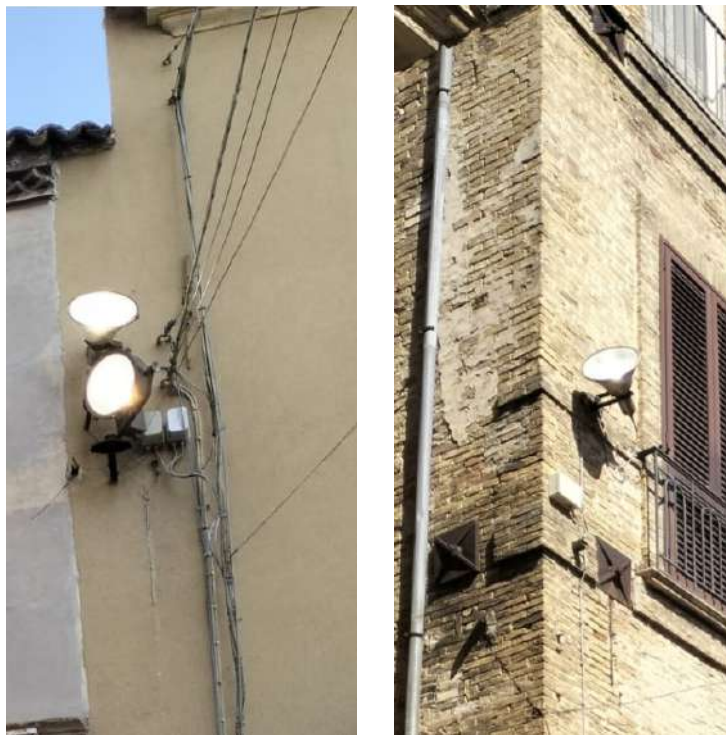
Proiettori esistenti per l'illuminazione di facciata e campanile
